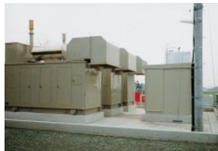
自家発電システムの外観
