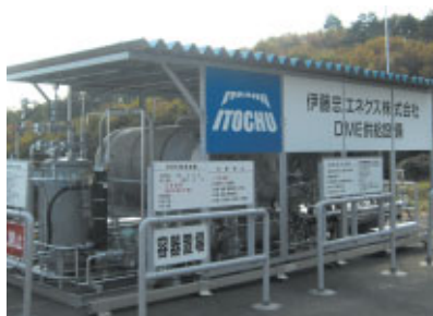
DME燃焼試験設備
