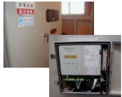
受変電設備保守監視システム
