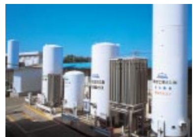
高圧ガスタンク
