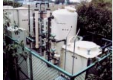
「地下水膜ろ過システム」
