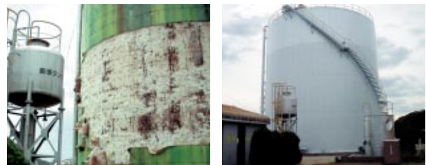
2004年10月の台風23号によって、佐世保アスファルト基地の保温板（側面、天井）がはがれ、同敷地や港に散乱しました。産業マテリアル事業本部では、保温板を回収するとともに、老朽化対策として予定していた修理を全面改修へと切り替え、対応しました。
