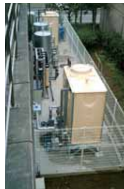
地下水膜ろ過システム
