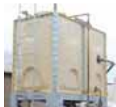
■ 井戸設備、貯水槽
