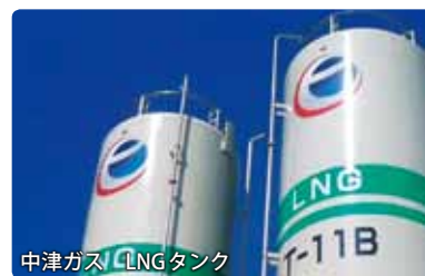
中津ガスLNGタンク
