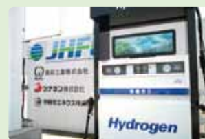
水素ステーションの設備
