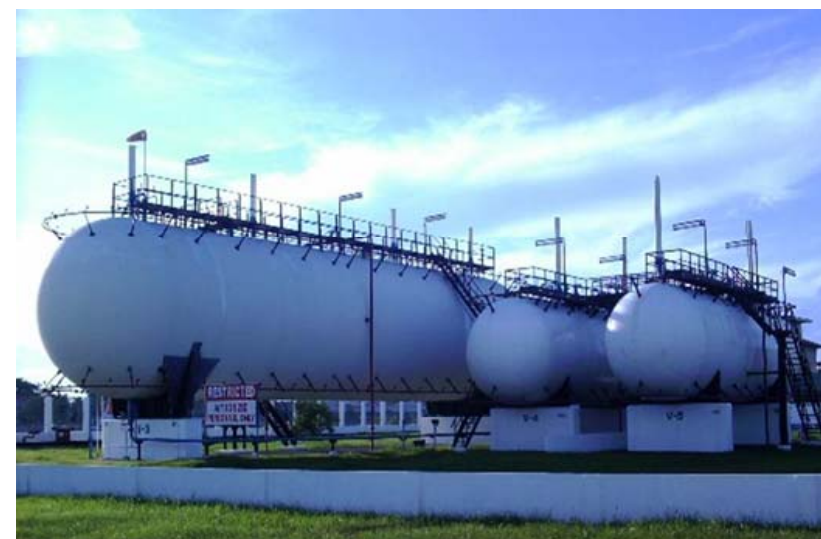
タバングオターミナルの高圧タンク
