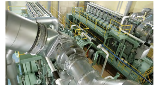
ガスエンジン発電設備
