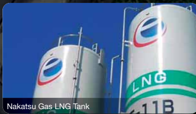
Nakatsu Gas LNG Tank
