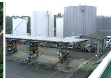
大井川油槽所
