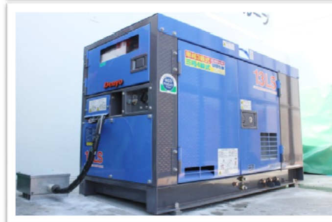
緊急時用の自家発電装置を配備
