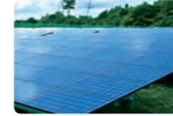
太陽光発電所
