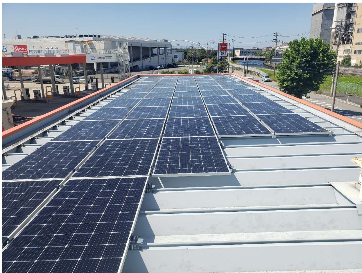
② キャンプー（CS 屋根）に設置した太陽光パネル
