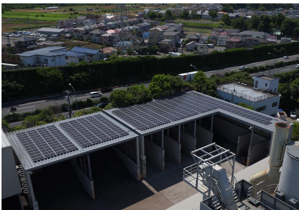
(太陽光パネル全景)
