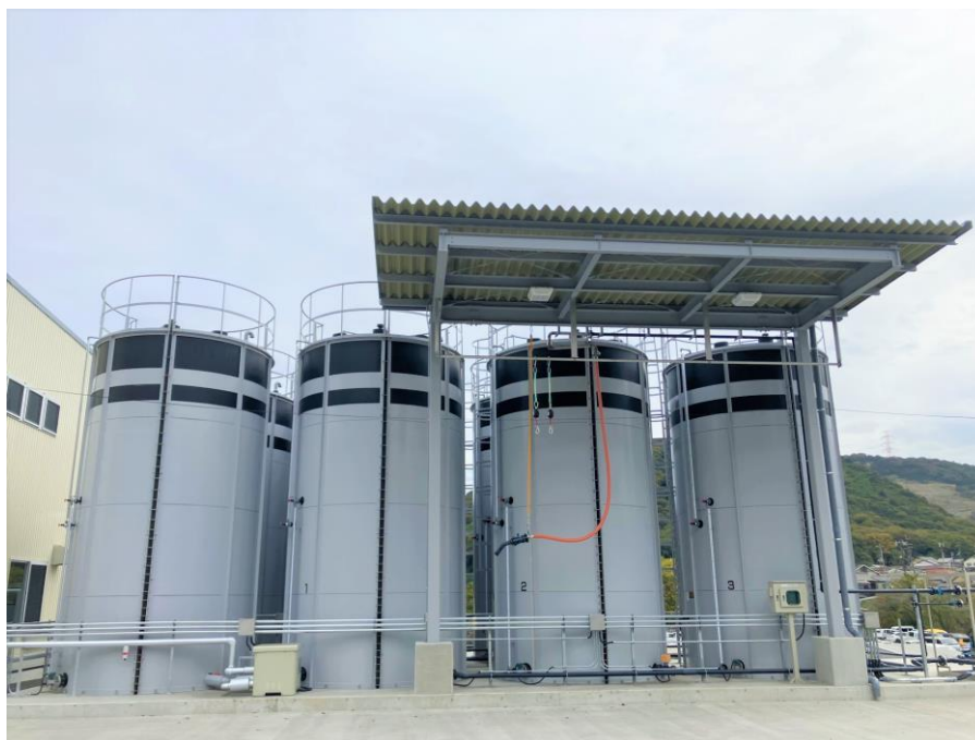
新工場に整備した尿素水を貯蔵するタンク
